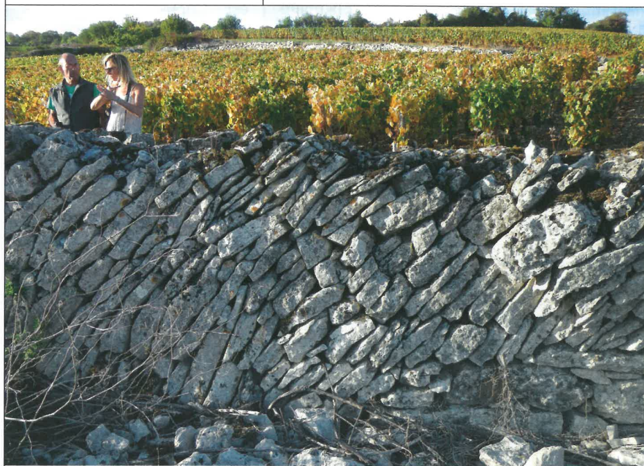
Soutènement pour l'accès au vignoble qui sert aussi de pierrier (abri à biodiversité), St-Romain, Côte de Beaune.
